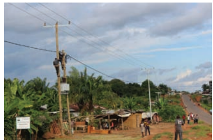
Ganta electrification (WAPP)
